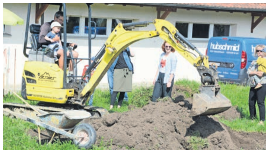
Beim Spatenstich für die Theatergrube durfte die ganze Bevölkerung mitmachen. Selbst die Kleinsten durften sich auf den (kleineren) Bagger setzen.
